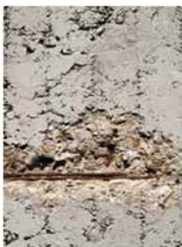
Figura 22 – Broca ou bicheira em elemento de concreto
